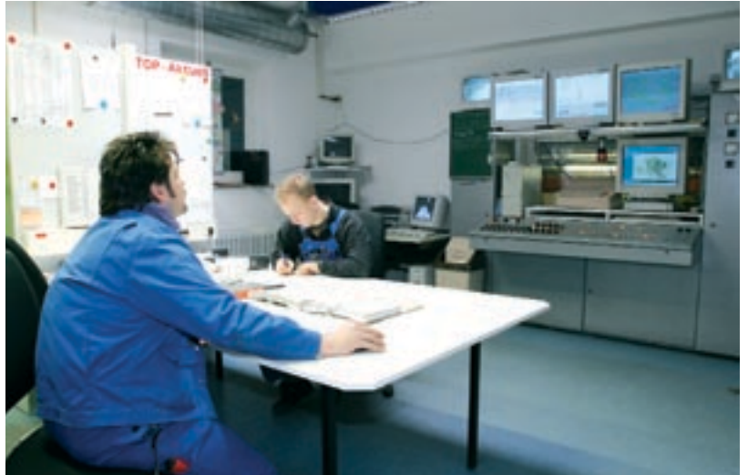
Alles unter Kontrolle – die Mitarbeiter der Fördertechnik sind jederzeit bereit, falls Störungen auftreten.
